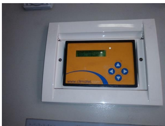
Figura 4.9 - Particolare della centralina di controllo della centrale termica
