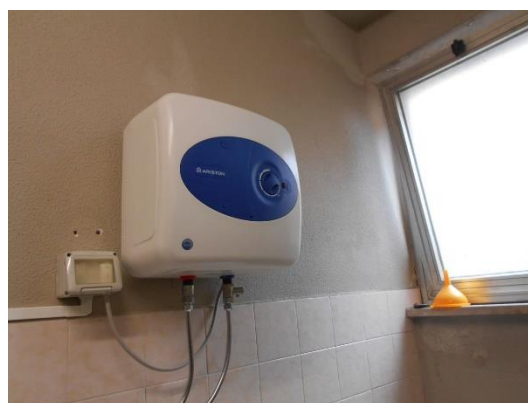
Figura 4.16 - Particolare di un boiler elettrico per la produzione di acqua calda sanitaria
