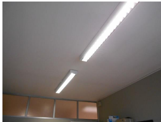
Figura 8.11 - Particolare di una plafoniera a tubi fluorescenti
